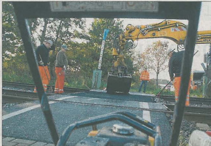
Gestern Morgen waren die Arbeiter dabei, den Bahnübergang an der Tergaster Straße mit Asphalt zu erneuern.
